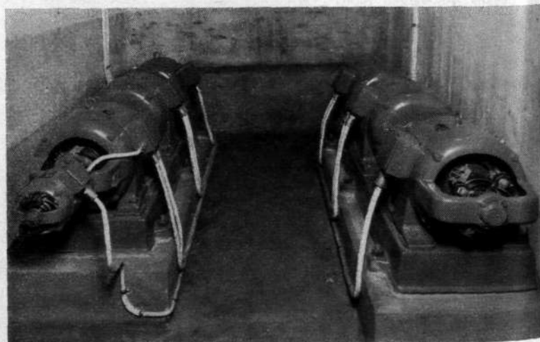
Fig. 5 Omformaraggregat för strömmatning av växeldriv- och förreglings- anordningarna samt spårledningarna
