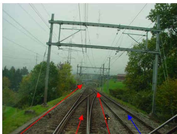
Weiche 11 Weiche 14 Gleis 22 - 17 Weiche 13, dahinter Weiche 12
