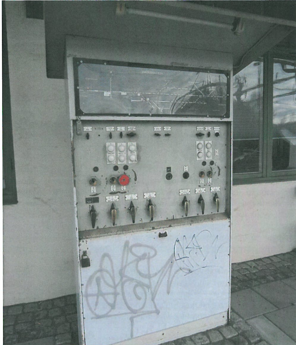
Figur 4. Signalställverket i Smedjebacken (Centralapparat).
