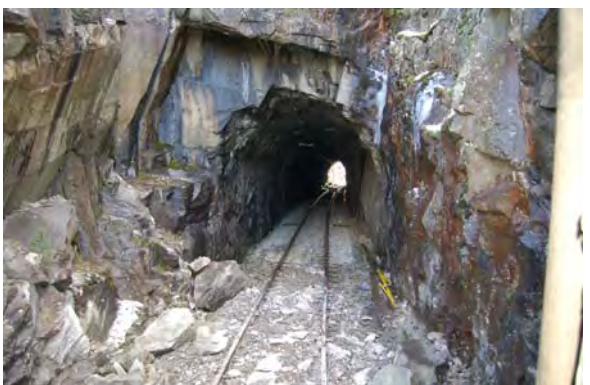
Figur 5: Viser området til venstre for tunnelåpningen hvor raset gikk
